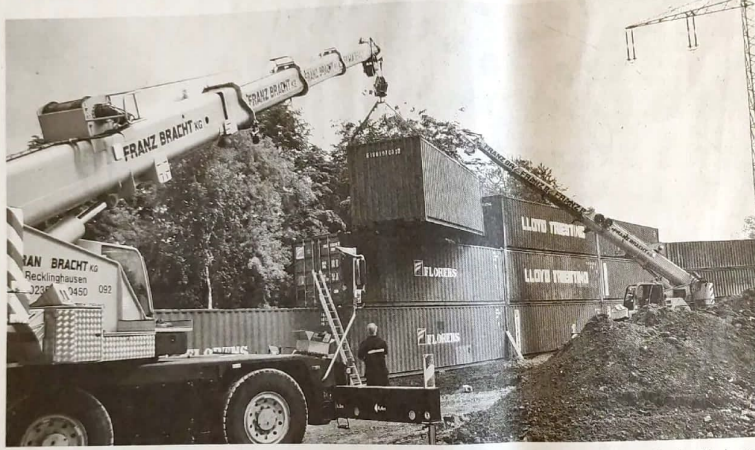
Bei diesem Großprojekt wurden Schallschutzwände aus mehr als 600 Seecontainern mithilfe zweier Kräne unterhalb einer Hochspannungsleitung justiert. FOTO: BLOEDORN CONTAINER DORTMUND
